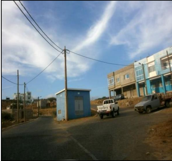
Figura 34 : Posto de iluminação pública no bairro
