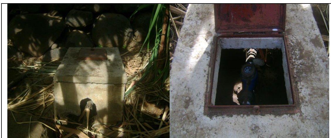
Figura 17 - Contadores instalados nas propriedades à jusante da BP Fonte: Foto do autor (5/01/2014)
