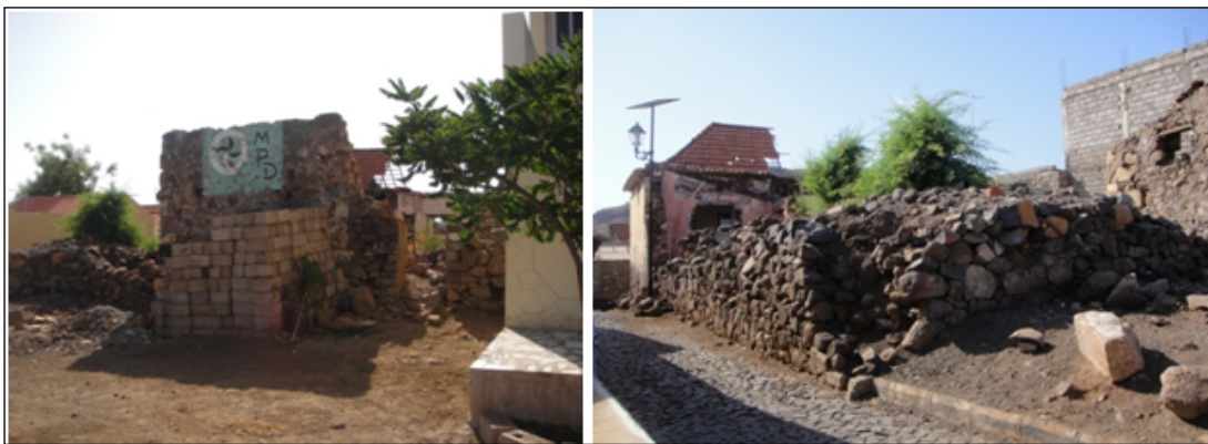
Figura 48 - Imagem da fachada lateral e da fachada posterior em escombros.
