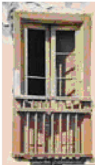
Figura 54 - Janela com varanda em madeira nobre (guarda ou grade) num sobrado em ruínas da cidade de S. Filipe.
