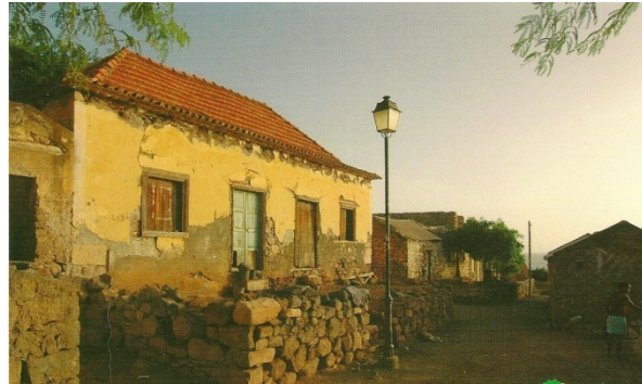
Figura 46 - Casa Senhorial em degradação.
