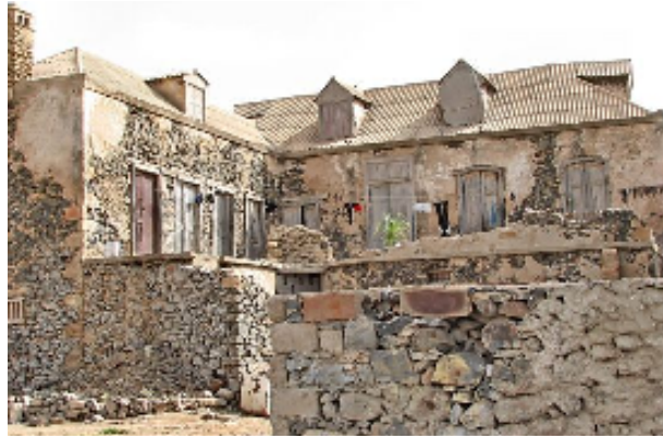
Figura 31 – Edifício degradado onde se pode verificar o modo de construção
