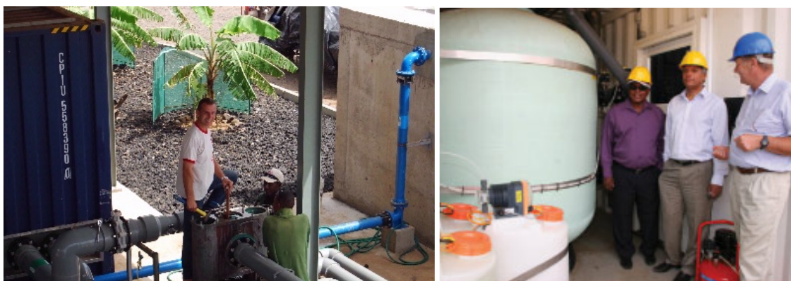
Figura 65 – Estação de tratamento de água
