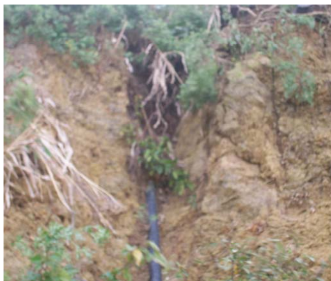
Figura 56. Imprecisão nos canais de drenagem. Fonte: Autora, 2009
