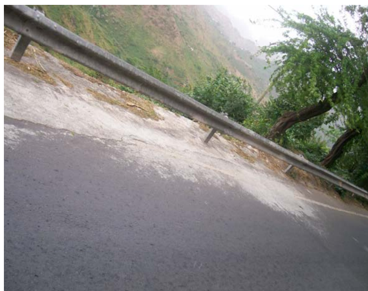
Figura 57. Inexistência de valas que levam o escoamento da água para os fundos dos vales. Fonte: Autora, 2009
