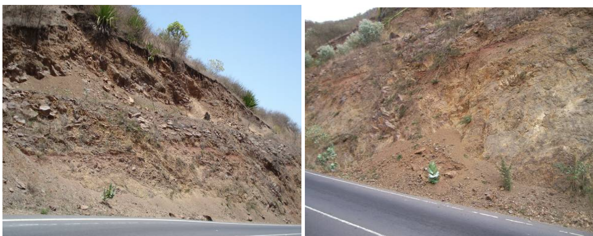
Figuras 84 e 85. Técnicas de contenção de erosão pouco eficazes no trecho 1. Fonte: Autora, 2009
