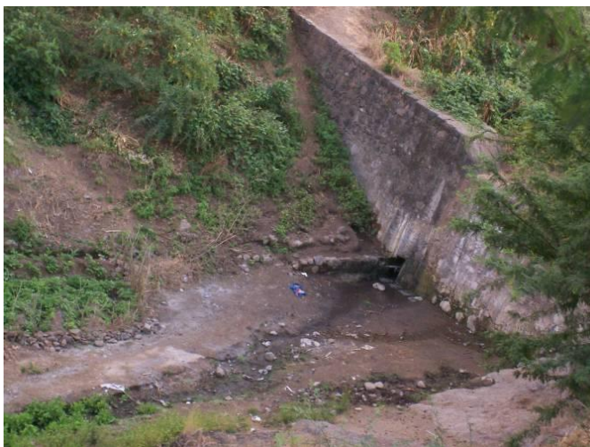
Figura 40. Possível contaminação da água proveniente do asfalto na zona de Órgãos Pequeno. Fonte: Autora, 2009
