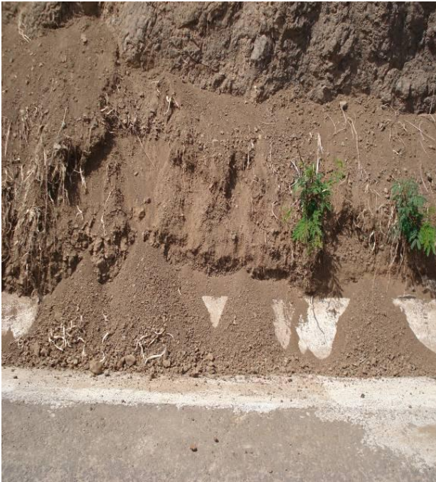
Figura 24. Deslizamento de terra para dentro da via na zona de Godim. Fonte: Autora, 2008
