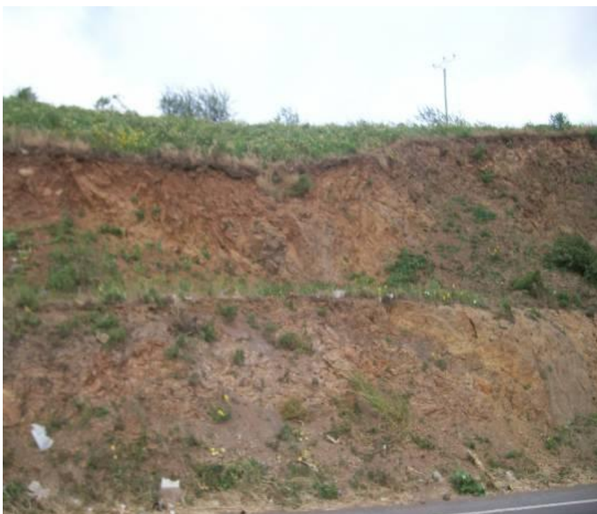
Figura 86. Técnicas de contenção ineficazes no Trecho 3. Fonte: Autora, 2009
