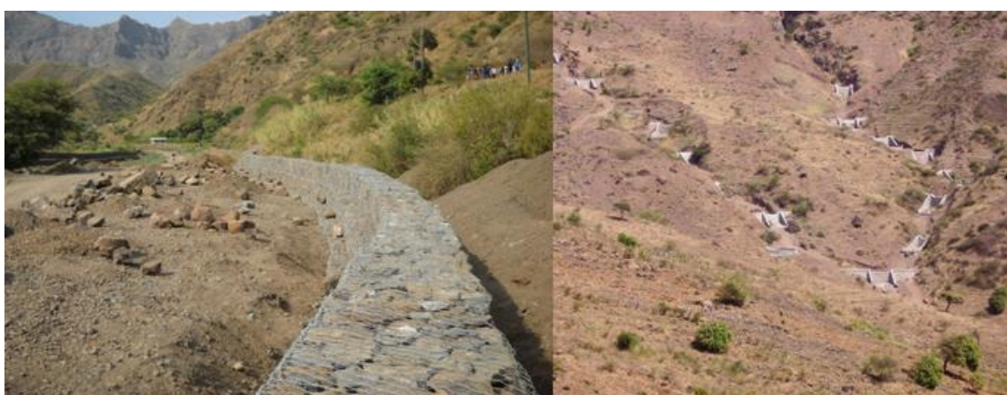
Figura 2.2 - Infraestruturas de correção torrencial construídos na Bacia Hidrográfica dos Engenhos.
