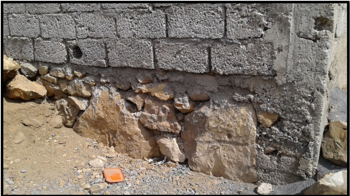
Figura 24: Construção sem viga de travamento.
