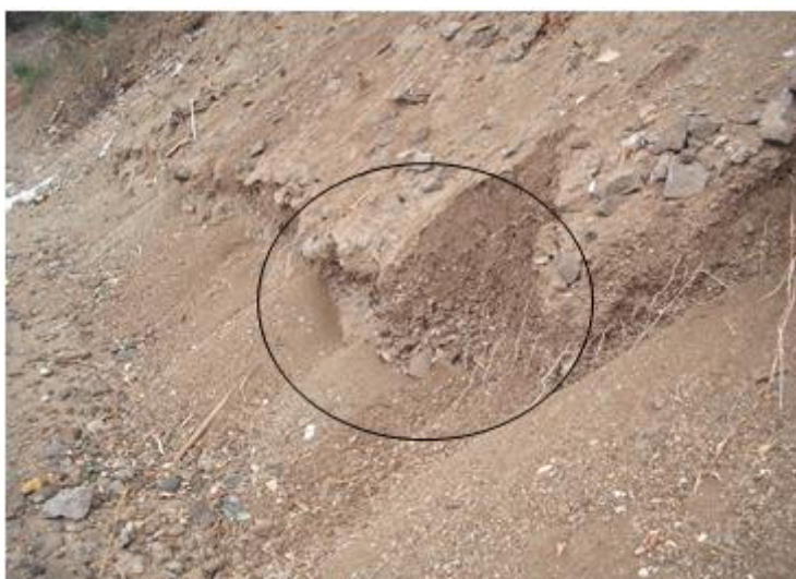
Figura 25 - Movimento de terras formando cones de dejeção na encosta de Lém Ferreira/Achada Grande Trás, 2011
