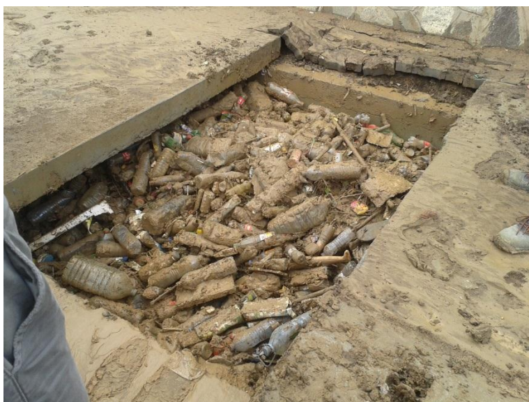
Figura 19 – Canal de drenagem artificial obstruída com resíduos sólidos arrastados e depositados pelas cheias (Várzea)
