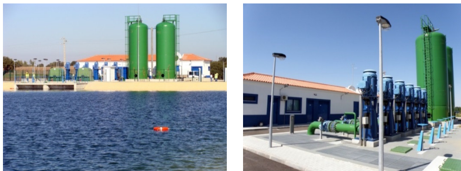
Foto 3-8 – Estação Elevatória EE 4.1 e Reservatório R4.1 12
