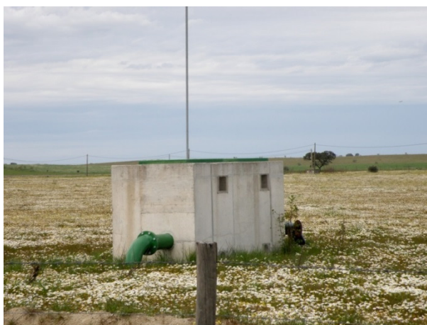
Foto 3-10 – Hidrante de rega 15
