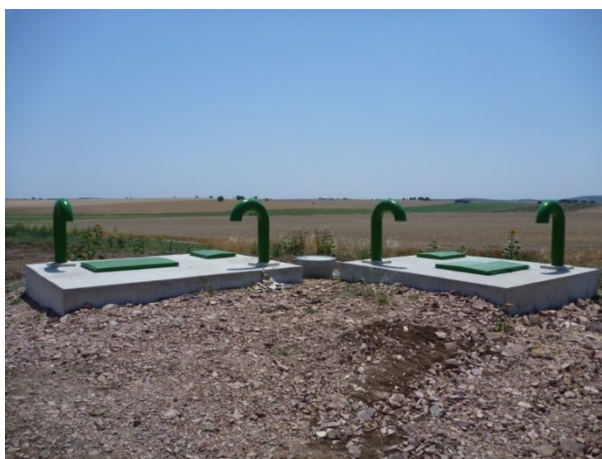
Foto 3-20 – Caixas de Válvulas 27
