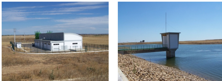
Foto 4-9 – Estação Elevatória e Reservatório do Bloco 3 de Odivelas 41
