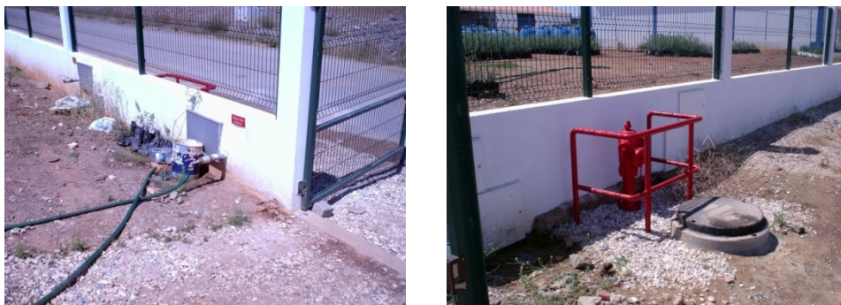
Foto 3-14 – Rede Doméstica e Boca-de-Incêndio 20
