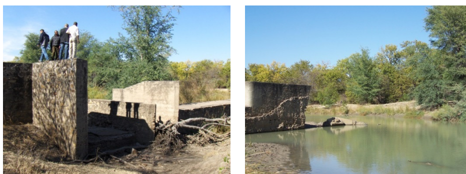
Foto 6-2 – Ruína do Açude no Rio Caculuvári na Cahama, Cova do Leão 46
