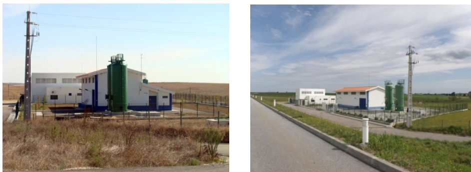
Foto 3-7 – Estações Elevatórias EE4 (rega) e de Adução ao Monte Novo (2º plano) 10
