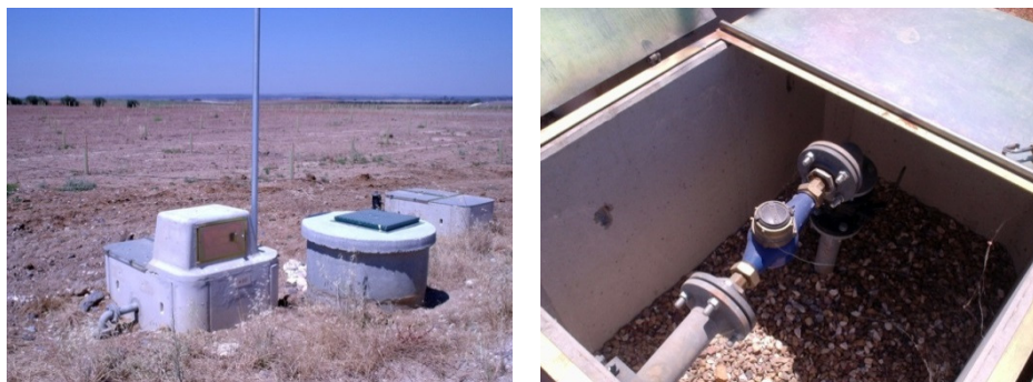
Foto 3-15 – Hidrantes e Tomadas em Rede de Aproximação 21
