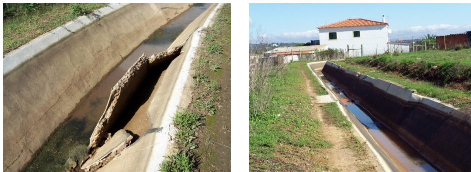
Foto 4-2 – Estado de Conservação dos Canais do Alvor 33
